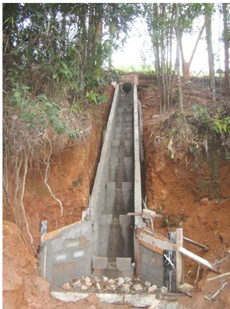
Figura 9: Dissipador de energia em degraus
