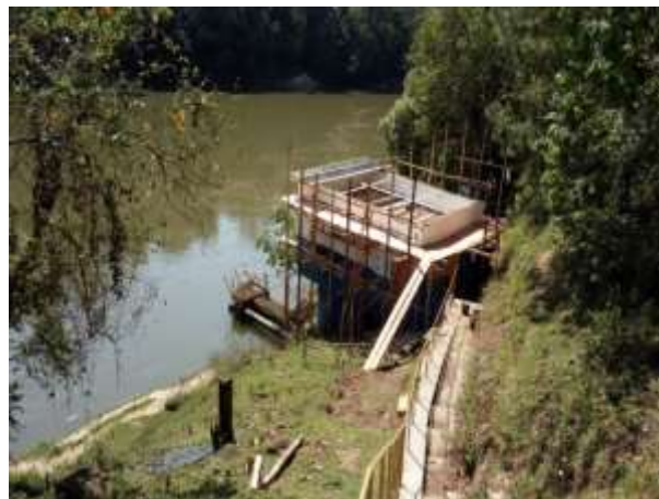
Figura 51: Local de captação superficial no Rio Tibagi.
