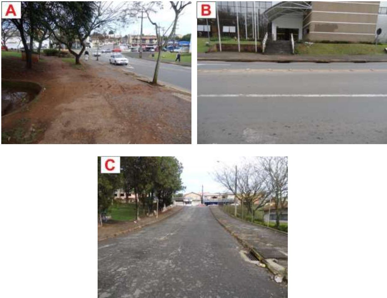
Figura 103: Exemplos de ruas com pontos baixos em Telêmaco Borba em frente à Secretaria de Educação (A) e (B); em frente a Praça da Concha Acústica (C).
