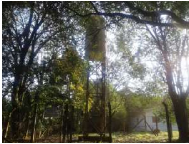
Figura 60: Reservatório Elevado (REL-03) – Triângulo.
