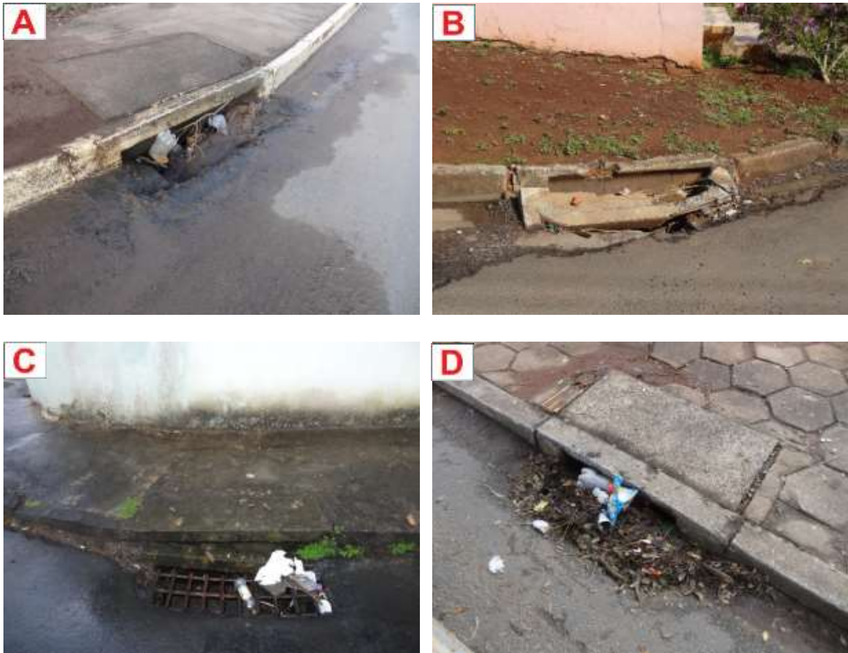
Figura 94: Bocas de lobo quebradas e/ou obstruídas nos bairros Bom Jesus (A), Jardim Bandeirantes (B), Bela Vista (C) e Perpétuo Socorro (D).
