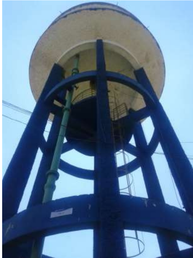
Figura 56: Reservatório Elevado (REL-02) – Alto das Oliveiras
