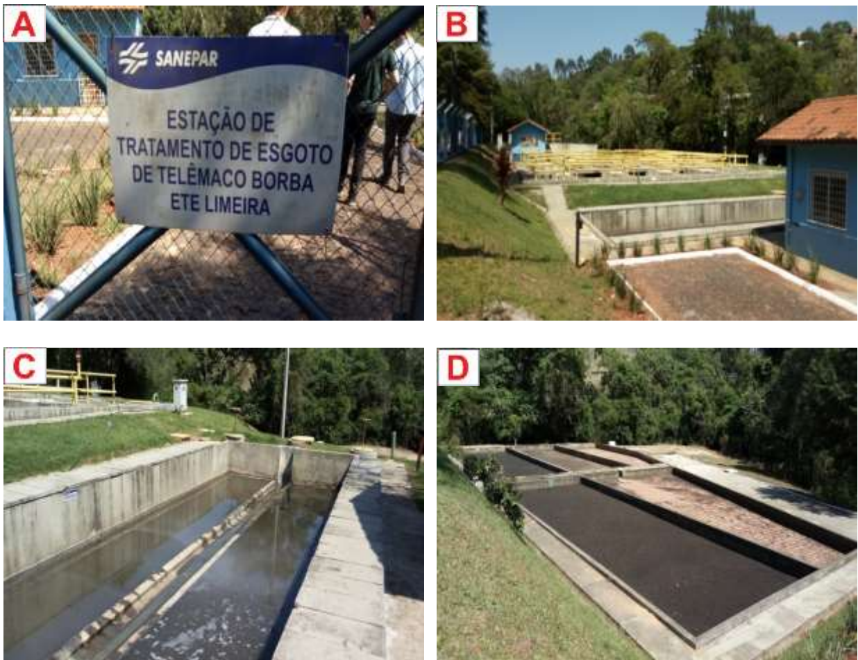
Figura 78: ETE Limeira - Detalhe da sinalização (A), vista geral (B), sedimentador (C) e leito de secagem (D).
