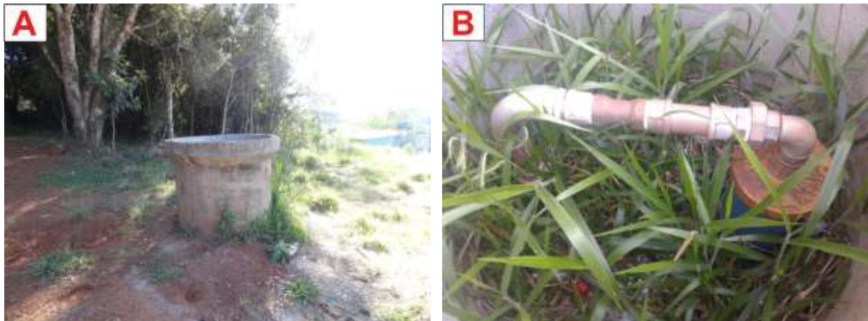
Figura 66: Poço de Captação da Vila Rural - vista do local do poço (A) e local de captação (B).
