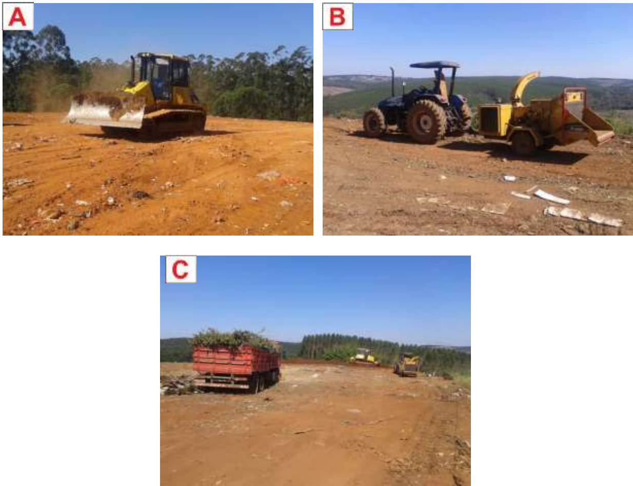
Figura 142: Trator esteira (A), picador de resíduos verdes (B) e caminhão coletor de resíduos verdes (C).
