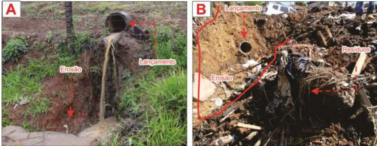
Figura 30: Problemas de drenagem associados a pontos de lançamento de águas pluviais nos bairros Água Verde (A) e Santa Rita (B).
