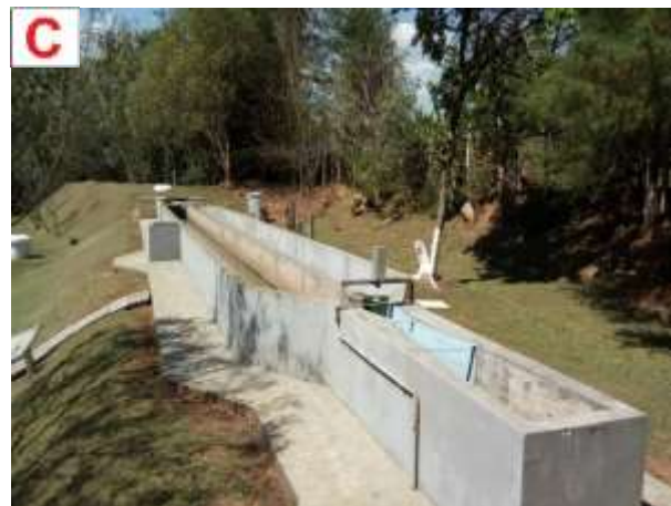
Figura 79: ETE Uvaranal detalhe da sinalização (A); vista geral (B); desarenador (C).
