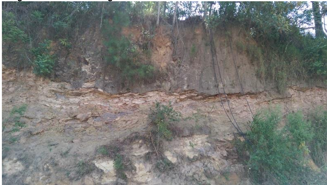
Figura 25: Cicatriz de escorregamento em talude na Estrada dos Guararapes, margem direita do Rio Tibagi.
