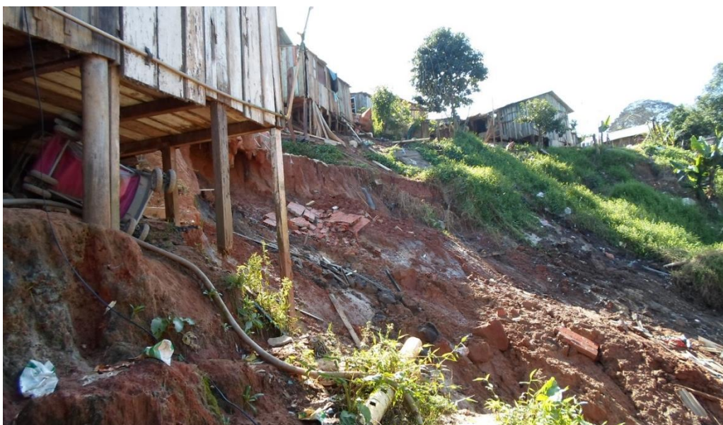
Figura 27: Desmoronamento ocorrido no Jardim União, em época de precipitação intensa.
