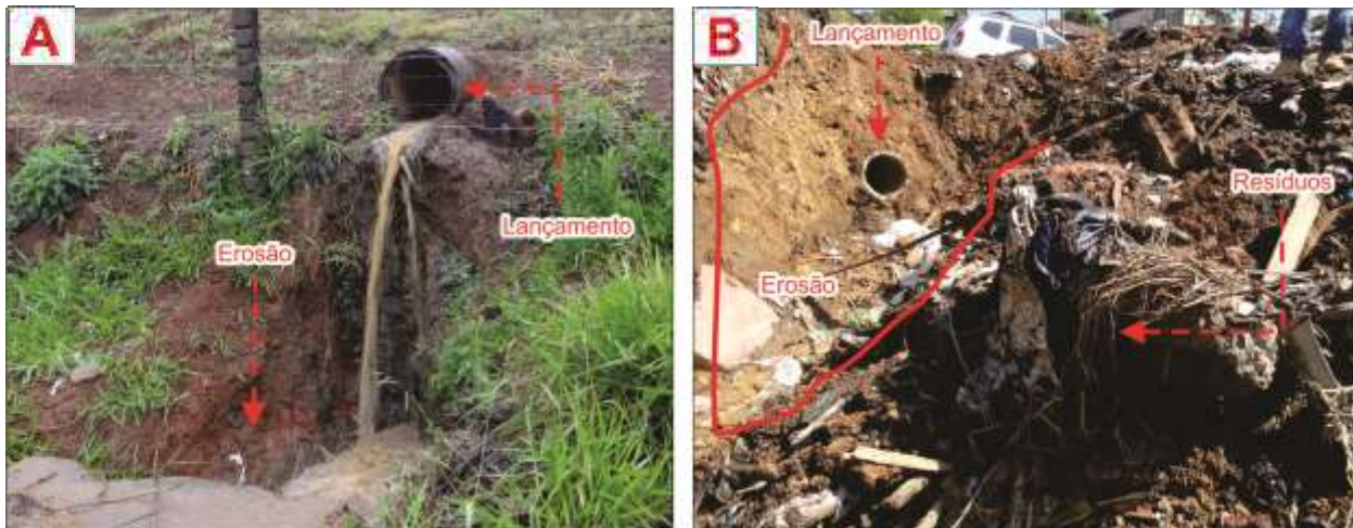
Figura 30: Problemas de drenagem associados a pontos de lançamento de águas pluviais nos bairros Água Verde (A) e Santa Rita (B).
