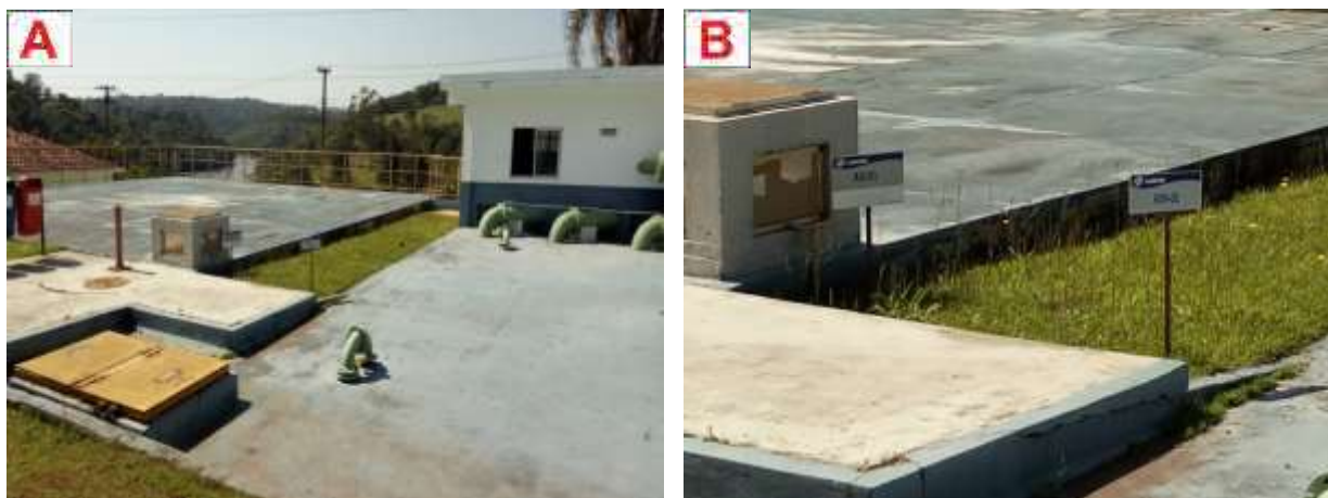
Figura 55: Reservatórios RSE-01 (A) e REN-02 (B) na Estação de Tratamento de Água.
