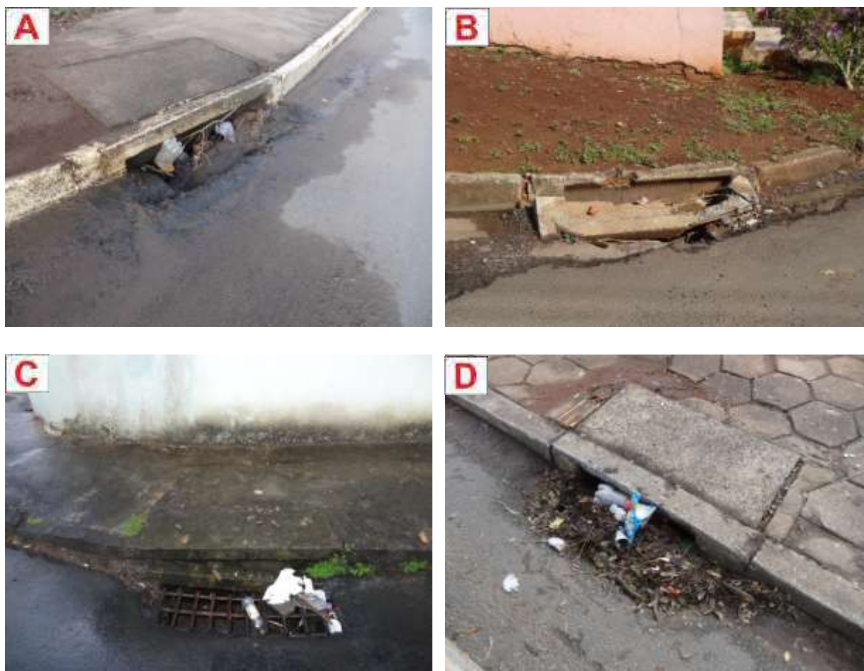
Figura 94: Bocas de lobo quebradas e/ou obstruídas nos bairros Bom Jesus (A), Jardim Bandeirantes (B), Bela Vista (C) e Perpétuo Socorro (D).
