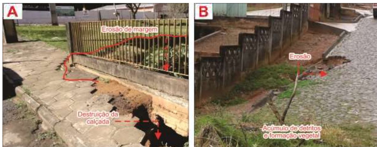
Figura 26: Problemas de drenagem nos bairros Jardim Kroll (A) e Vila Esperança (B).
