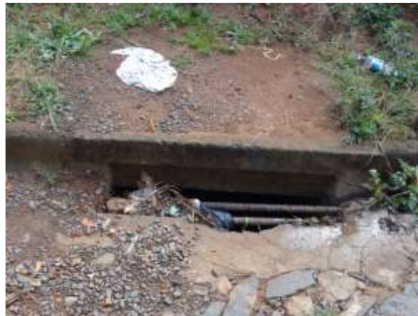
Figura 133: Boca de lobo com resíduos no entorno – Bairro Vila Ozório.
