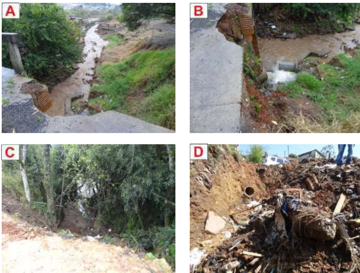
Figura 97: Pontos de erosão nos lançamentos das águas pluviais nos bairros Jardim Alegre (A) e (B); Macopa (C) e Santa Rita (D).
