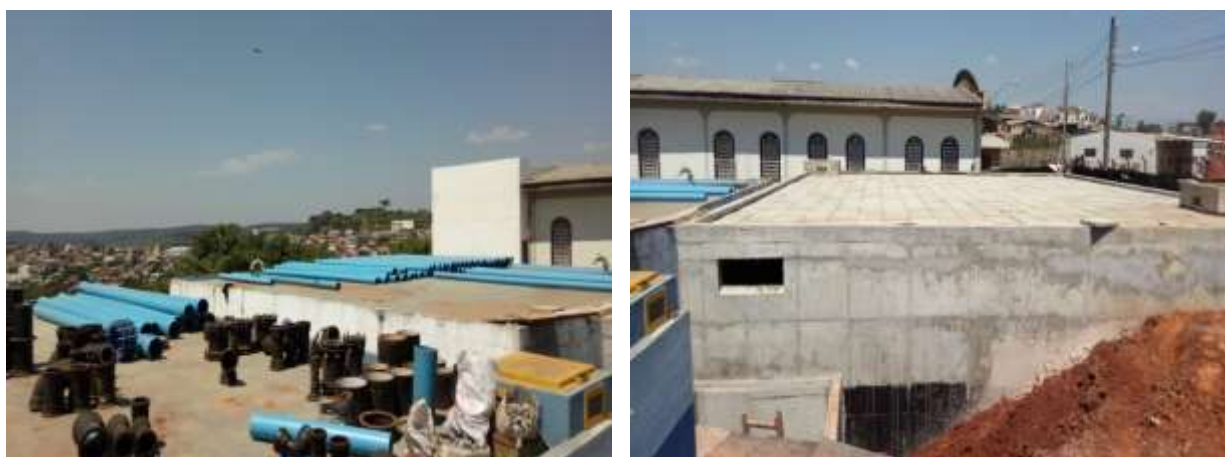
Figura 59: Reservatório Campina Alta.
