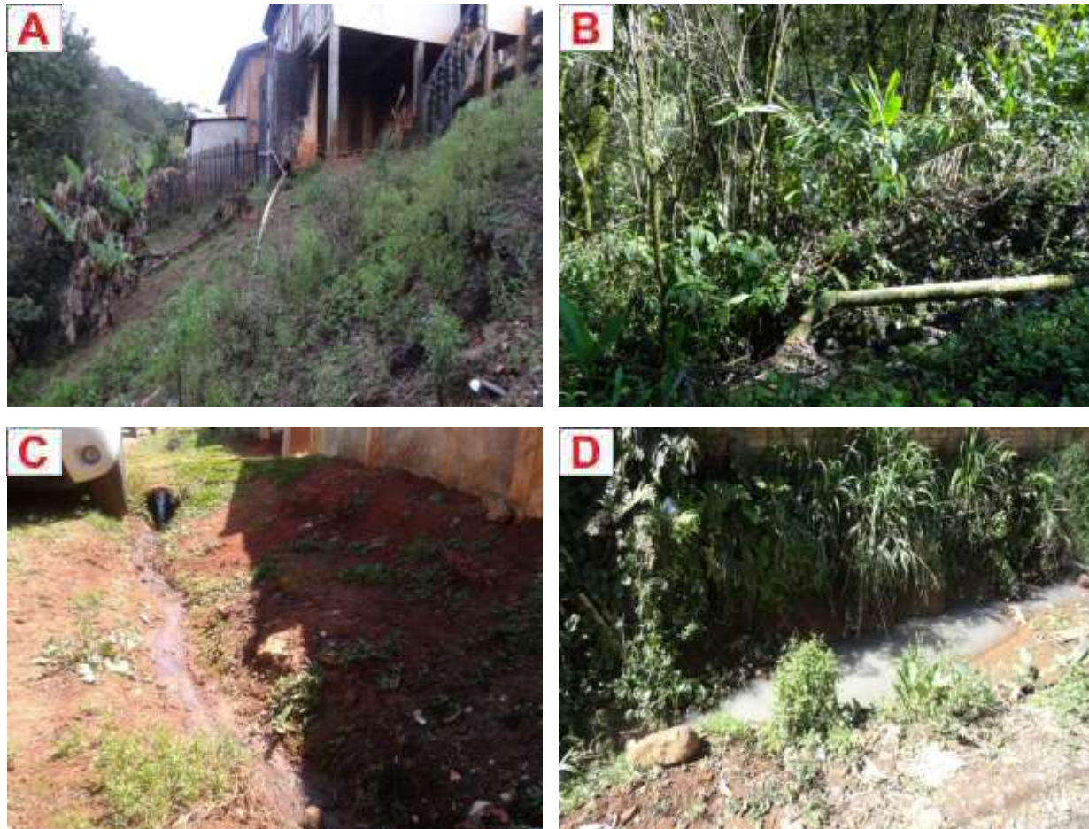
Figura 96: Possíveis ligações irregulares na rede de drenagem nos bairros Santa Rita (A) e (B), São João (C) e (D).
